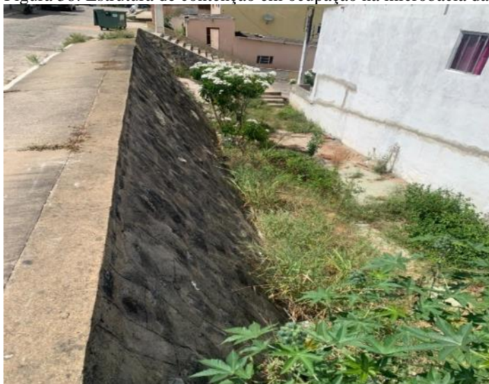
Figura 38: Estrutura de contenção em ocupação na microbacia da nascente Pau Pombo.
