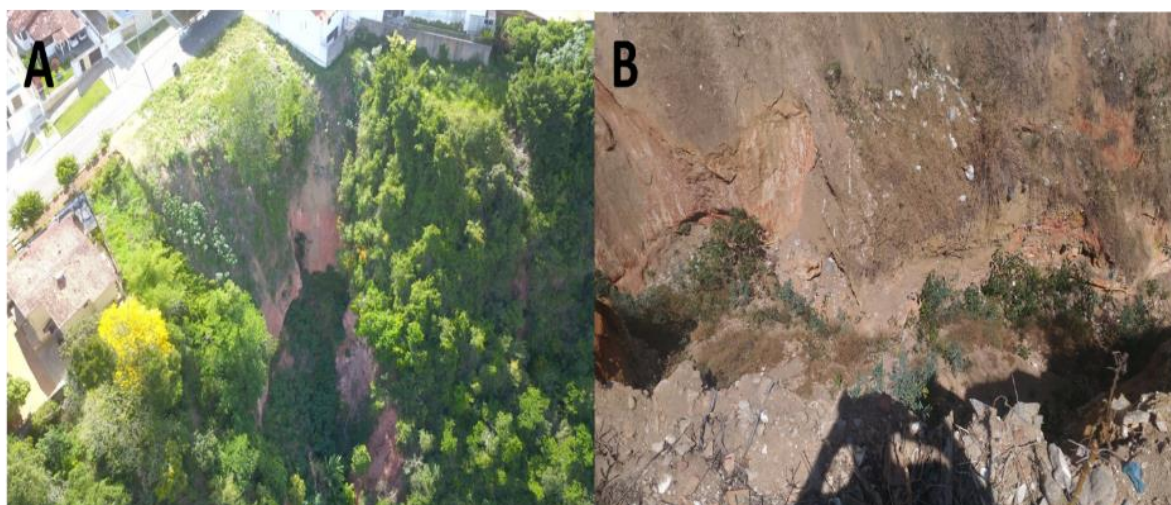
Figura 25: Vestígios de instabilidade nas encostas do Vale da Liberdade.
