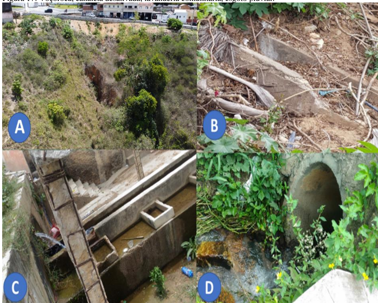
Figura 17: Voçoroca, canaleta desativada, lavanderia comunitária, esgoto pluvial.
