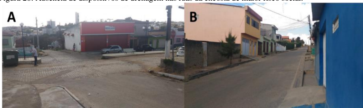
Figura 28: Ausência de dispositivos de drenagem nas ruas da encosta de maior risco social.
