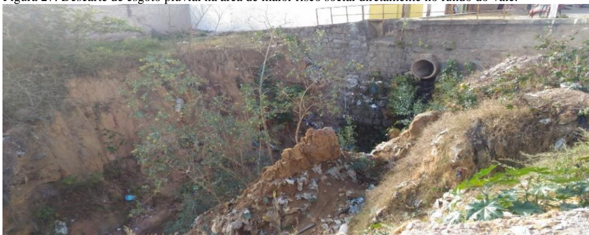
Figura 27: Descarte de esgoto pluvial na área de maior risco social diretamente no fundo do vale.
